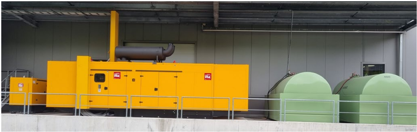
Slika 4: Agregat VISA P1250S in rezervoarja za gorivo na lokaciji Dobje
